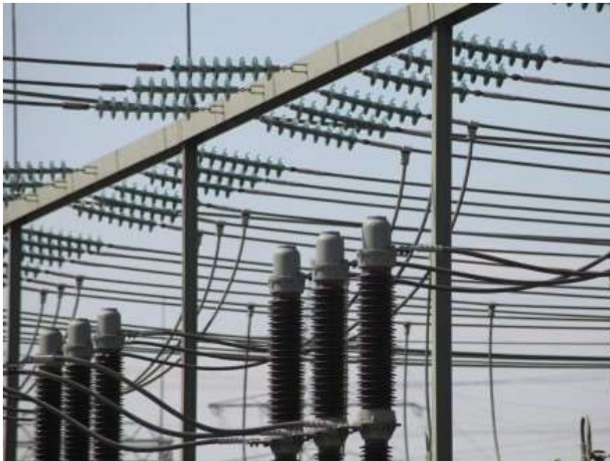
Strommast in einem Elektrizitätswerk (Deutschlandradio / Jan-Martin Altgeld )
