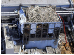
Luftaufnahme des zerstörten Reaktors 4 in Fukushima (Bild: AP)
